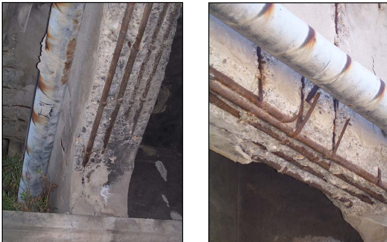
Figura 2: Particolare del degrado degli elementi strutturali del ponte
