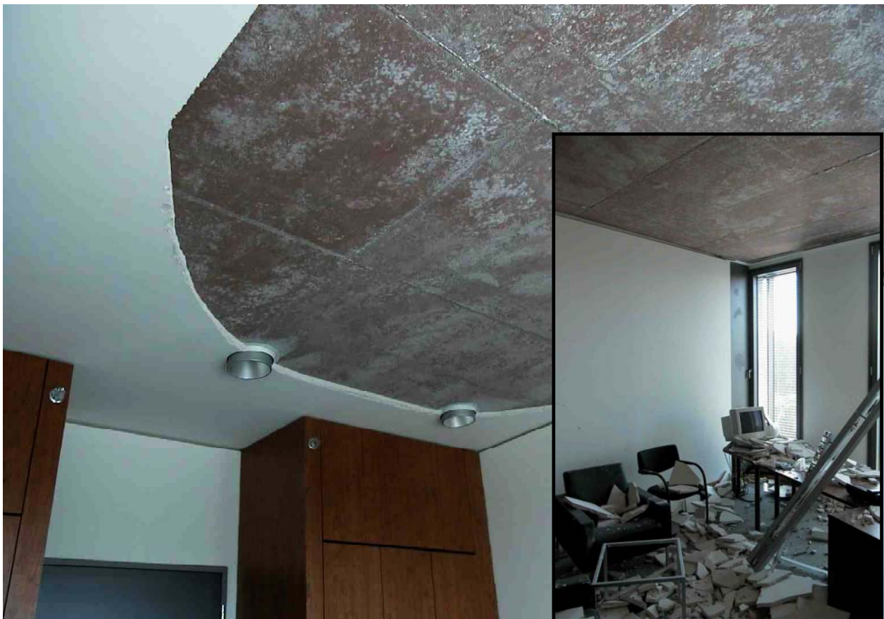
Abb. 1: Schadensbild an einer abgefallenen Putzdecke
