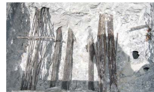
Sondierfenster mit Drahtbrüchen
