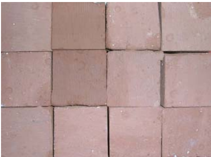
Abb. 18: Ziegelwand (z.T. durchfeuchtet), Aufnahme mit Digitalkamera
