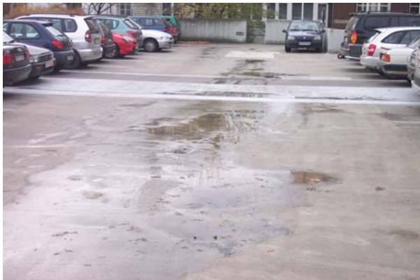
Bild 1: Pfützenbildung auf einem Parkdeck durch nicht funktionsfähiges Entwässerungssystem
