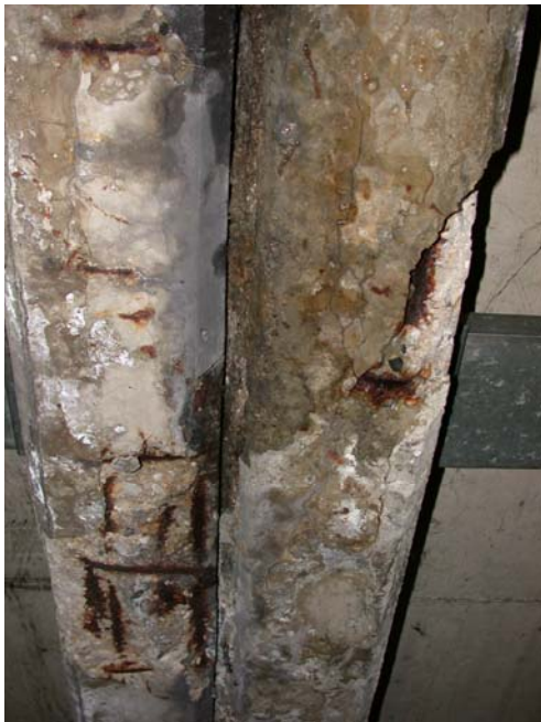
Bild 3: Erhebliche Korrosionsschäden an Unterzügen eines Parkhauses, die an eine undichte Fuge angrenzen
