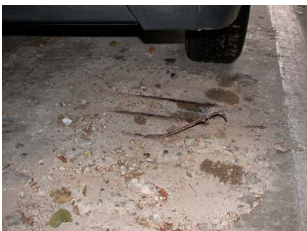
Bild 2: Zerstörte Betonoberfläche mit herausstehender Bewehrung in einem befahrenen Bereich eines ca. 30 a alten Parkhauses
