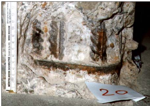
Bild 8: Nach dem Abstemmen der Nord-West-Kante (vgl. Bild 7) sichtbar gewordene korrodierende Bewehrung
