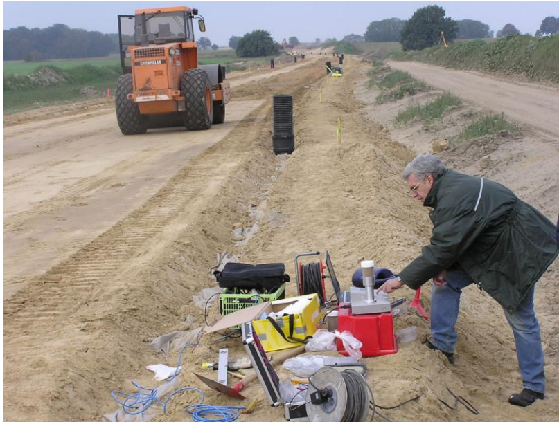
Abb. 4 Feinkalibration der Feuchtesensoren
