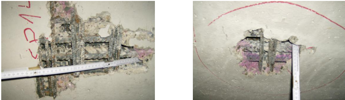
Abbildung 1 Zwei geöffnete, oberflächennahe Fehlstellen der untersuchten Messbereiche
