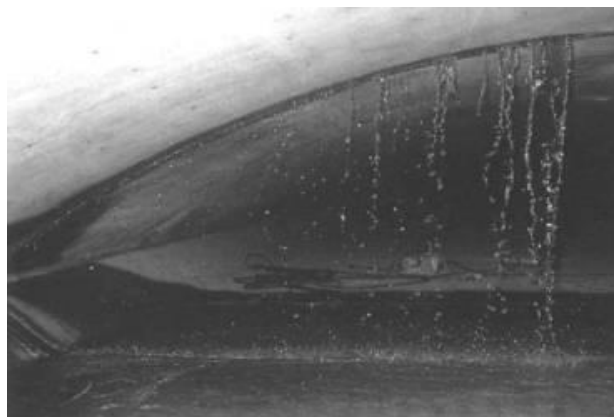
Bild 4 Wassereintritte in einem Tunnel
