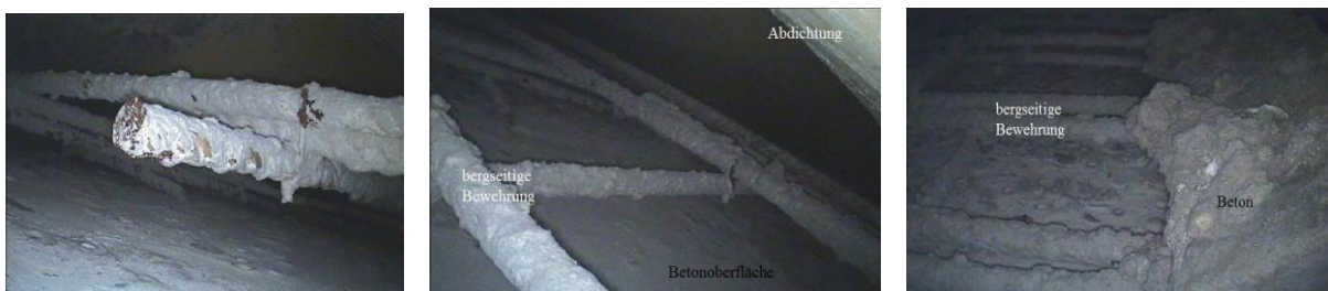
Bild 2 Fehlstellen mit freiliegender Bewehrung im Firstbereich von Tunnelinnenschalen
