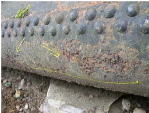
Figure 2 : exemple de perte d'épaisseur localisée affectant les conduites forcées.
