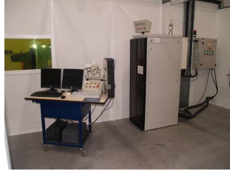
Le pupitre de contrôle du LUIS installé dans la zone sécuritaire.
