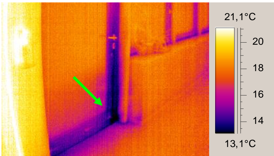
Bild 2: Defekte (verbogene) Fluchttüre aus Aluminium. Der Spalt ist mehr als 2 cm geöffnet, die verbogene Türe ist sogar im IR gut zu erkennen. Diese Türe ist kein Einzelfall.
