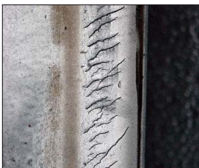
Bild 1: Head Check-Anzeigen einer MP-Prüfung
