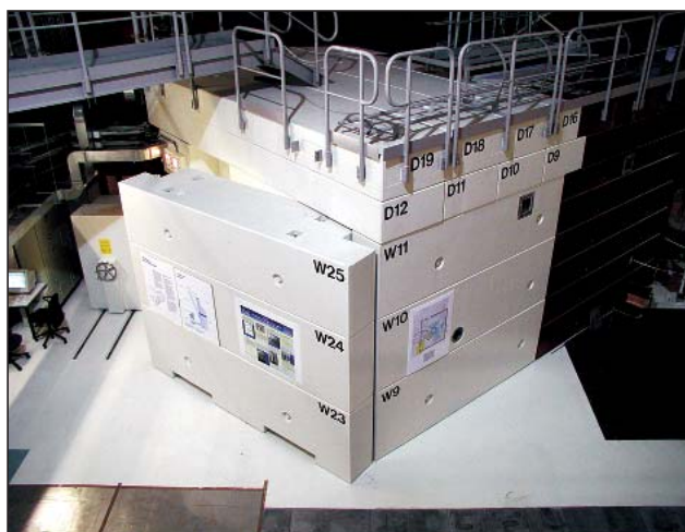
Bild 6: Blick auf die Abschirmburg bei leicht geöffneter Rückwand, in der sich NECTAR befindet
