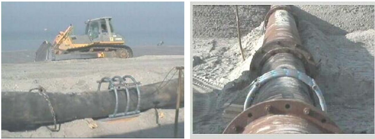
Abbildung 6: Durchlaufspulensystem zur Metaldetektion am Spülrohr eines Hopper-Baggers
