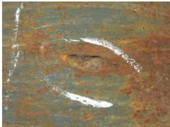
Abbildung 4: Ein nachgewiesener Fehler an der Außenseite der Rohrwand
