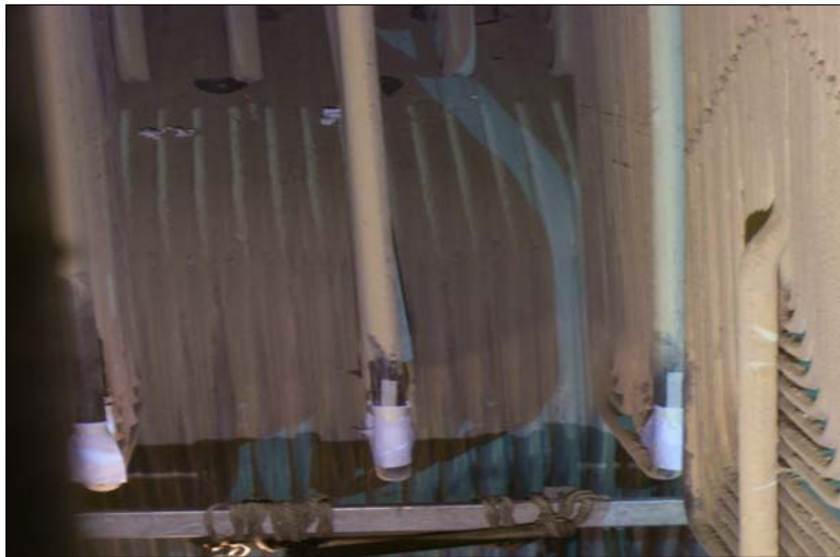
Figura 1. Zona E: Sobrecalentador de Alta Temperatura. Se observan tres zonas preparadas para obtención de réplica.
