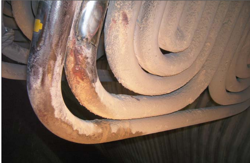
Figura 2. Zona E: Sobrecalentador de Alta Temperatura. Se observa una zona preparada con la réplica secándose.
